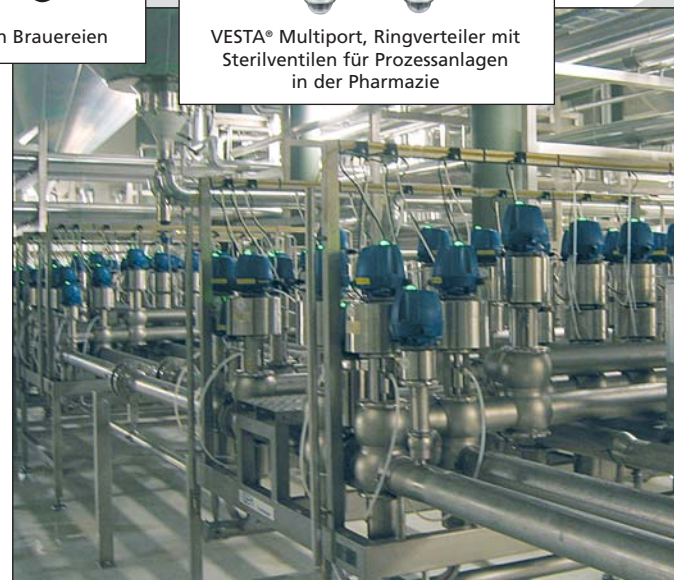
Ventilblock mit VARIVENT® Doppelsitzventilen und T.VIS® Steuerköpfen in einer Brauerei
