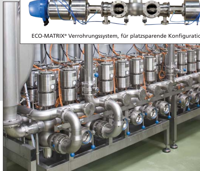
Ventilblock mit VARIVENT® Doppelsitzventilen in einer Molkerei
